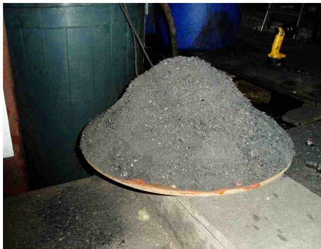
Figur 15: En del af den aske som havde fyldt og blokeret et af produktgassens vendekamre på rørsektionen lige efter gasgeneratoren.
