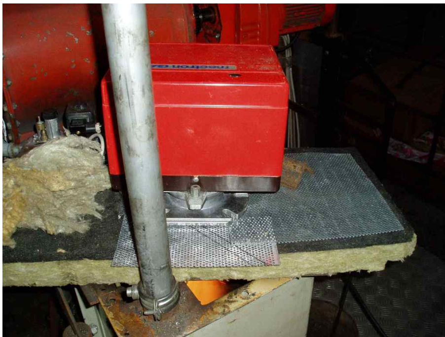
Figur 13: Mectron gasfyr til LPG gas midlertidigt placeret ovenpå indfyringstragten. Røret i forgrunden er den permanente topbrænder.
