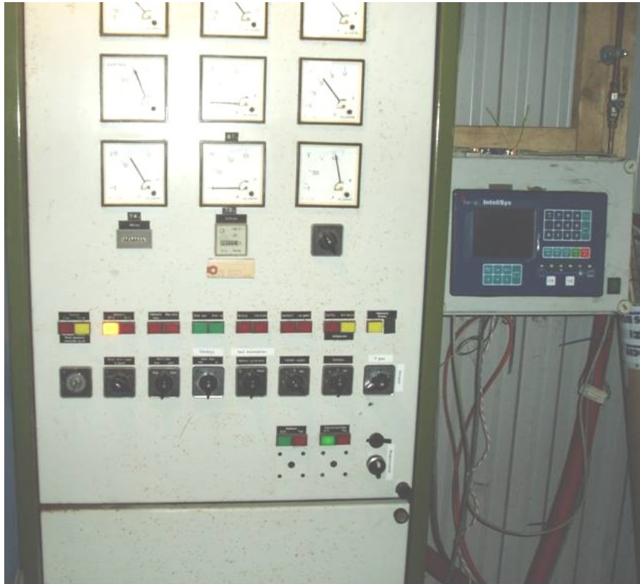
Figur 13: Det gamle motorstyringskab fyldt med relæstyringer blev erstattet af den lille blå elektroniske motorstyring, der her er hængt op under en test til højre i billedet.
