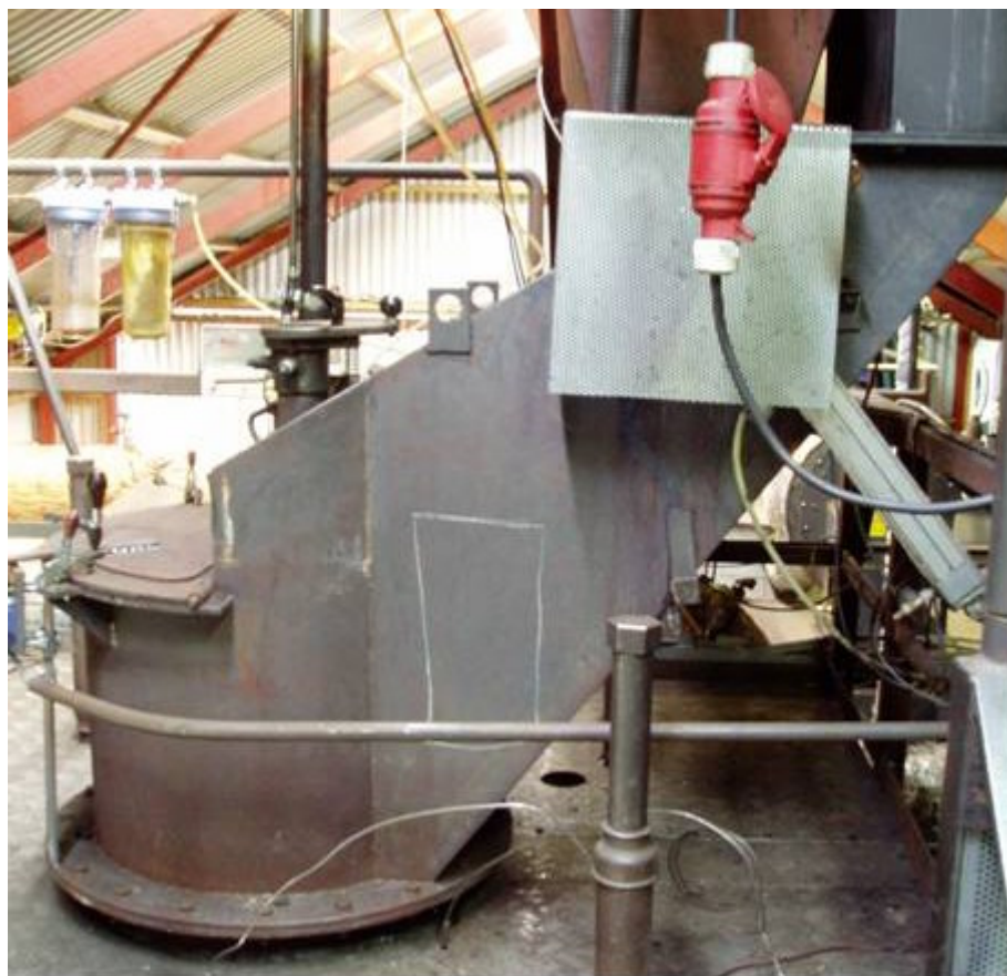
Figur 11: Det ny indfyringssystem er udført i kraftigere materiale og har en indbygget tætlukkende klap så celledslusen kan undværes. Øverst i højre hjørne skimtes det indbyggede aftræk til det fri. Det er afspærret under normal drift, men åbner under stilstand og eller hvis der opstår overtryk i indfyringssystemet.
