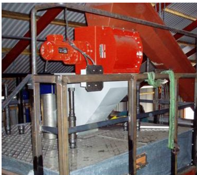
Figur 9: Den skrå snegl fører flisen op til indfyringssystemet. Det bestod oprindeligt af den røde cellesluse og den grå indfyringstragt. Begge komponenter var årsag til utætheder og gav anledning til en del driftsstop.
